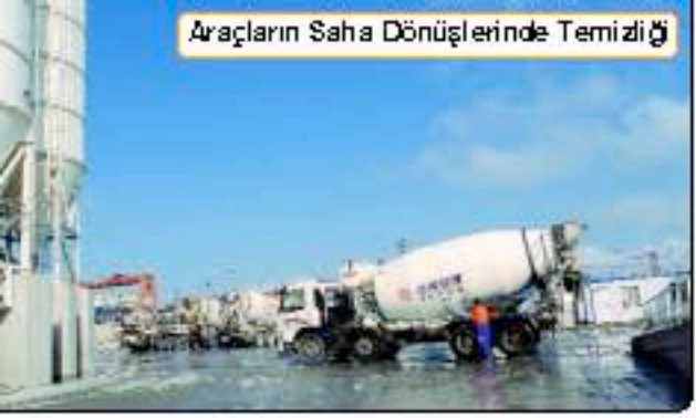
Geri Dönüşüm Ünitesi İnşaat dönüşü hazır beton mikserinin temizlik işleminin yapıldığı geri dönüşüm ünitesi
